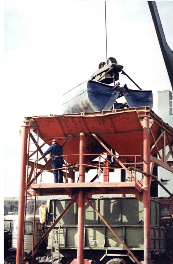
Fotografía 3. Nave y grúa de descarga en tolva de fertilizantes a granel sobre camión de porteo
